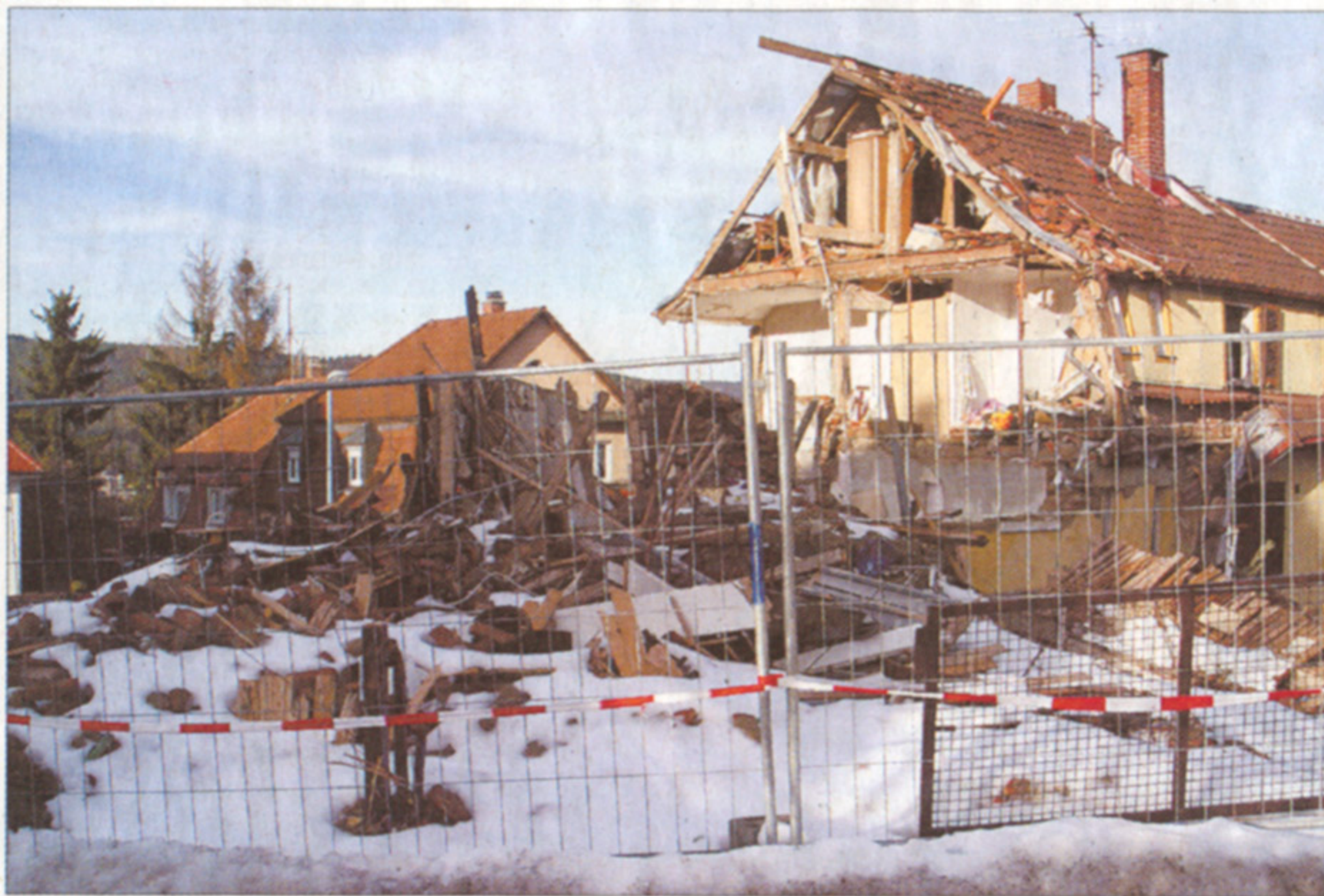
Das Trümmergrundstück auf der Ecke Freiburgstraße/Emminger Straße: Dort ereignete sich am 2. November eine verheerende Gasexplosion. Ein 15-jähriger wurde getötet, sein 64-jähriger Vater unter Mordverdacht festgenommen. Jetzt beging er in der Haft Selbstmord. Foto: Sabine Martin
